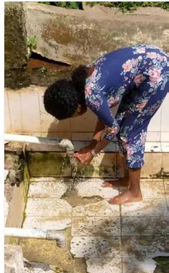
„Nur“ äußere Schäden an dem Gebäude mit der Quelle.
