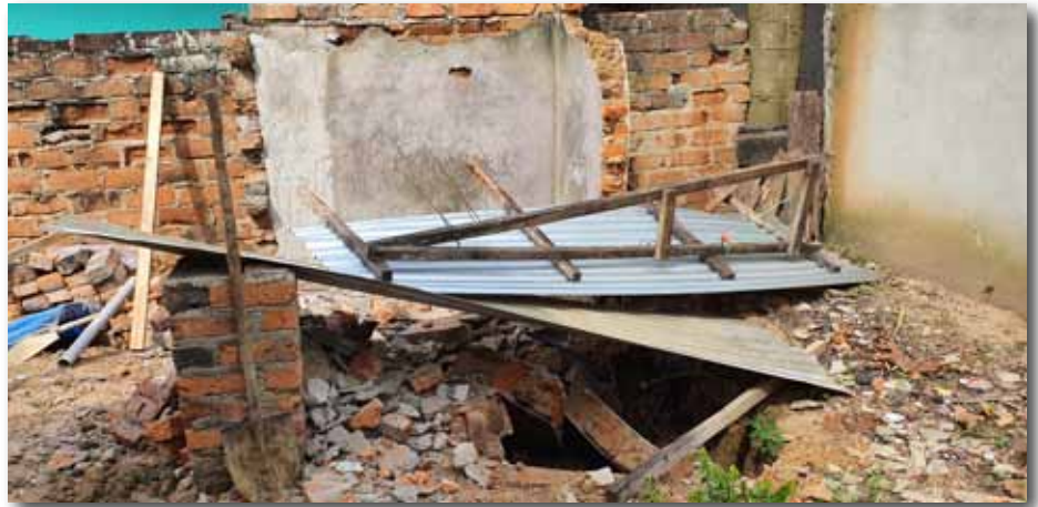
Von den „Rebellen“ zerstörte Toilette im Zentrum.
