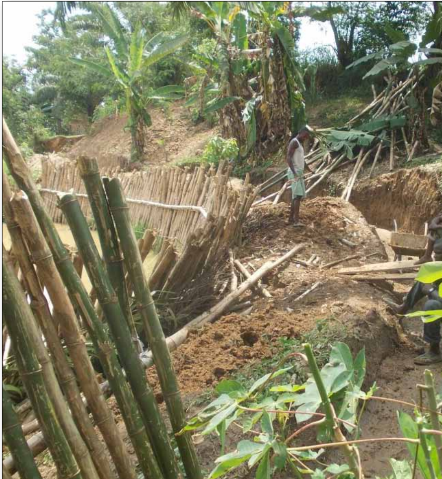
Alles Handarbeit: Mit Schaufeln und Schubkarren wird von Saisonkräften ein neuer Kanal für den Fischzuchtteich angelegt. Das verbessert die Wasserqualität, denn bisher gab es keinen Frischwasserzulauf.
