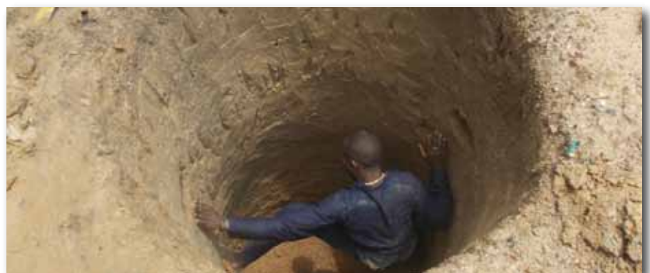
In der neuen Sickergrube wird zukünftig die Gülle aufgefangen, damit es nicht mehr zur Vermischung mit Oberflächenwasser kommen kann.
